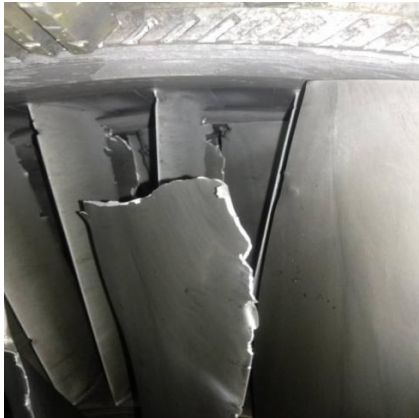
图 7 叶片断裂图 Fig. 7 The broken blade
